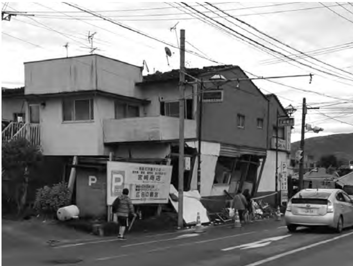
平成28年熊本地震による家屋の被害状況
