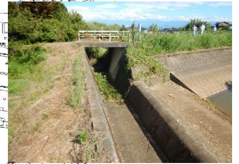
洪水吐の断面不足
