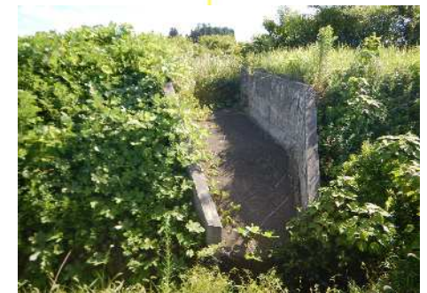
洪水吐の断面不足
