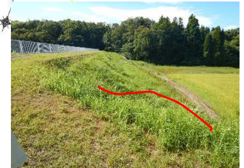
堤体のはらみだし
