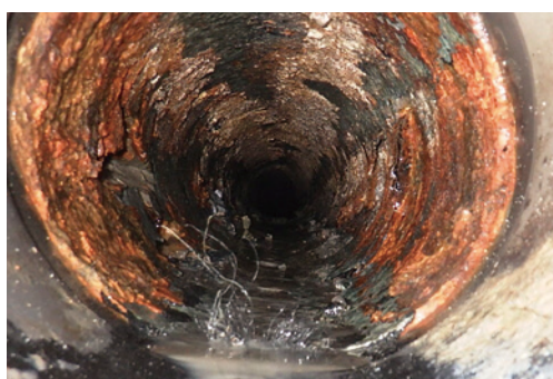
老朽化した污水管渠内
