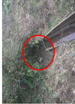
堤体からの漏水(がめ堤)
