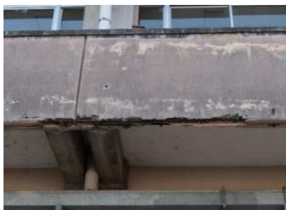
建造部外壁の破損部
