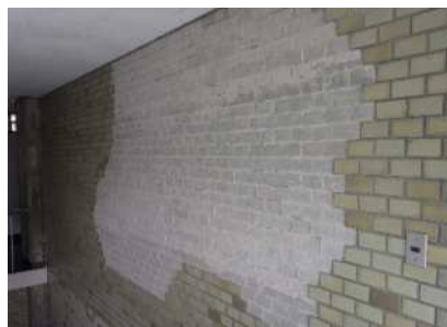
タイルが大きく剥がれた内壁
