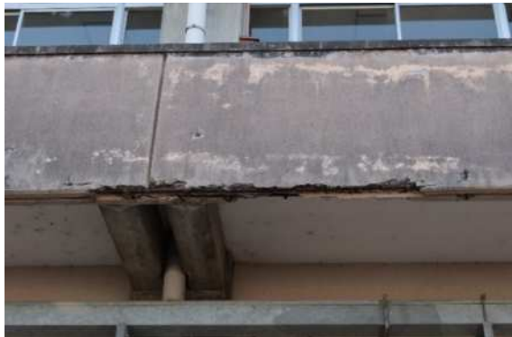
建造部外壁の破損部（再掲）
