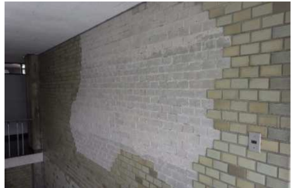
タイルが大きく剥がれた内壁（再掲）
