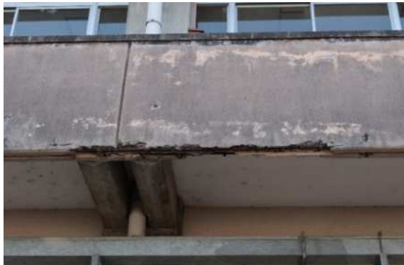
建造部外壁の破損部（再掲）
