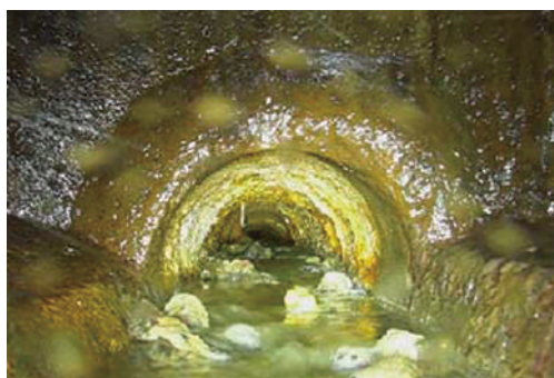
老朽化した污水管渠内
