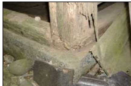
柱・土台の腐朽
