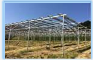
営農型太陽光発電設備
