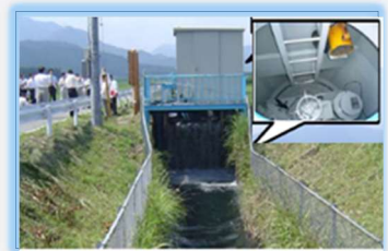
農業用水路を活用した マイクロ水力発電
