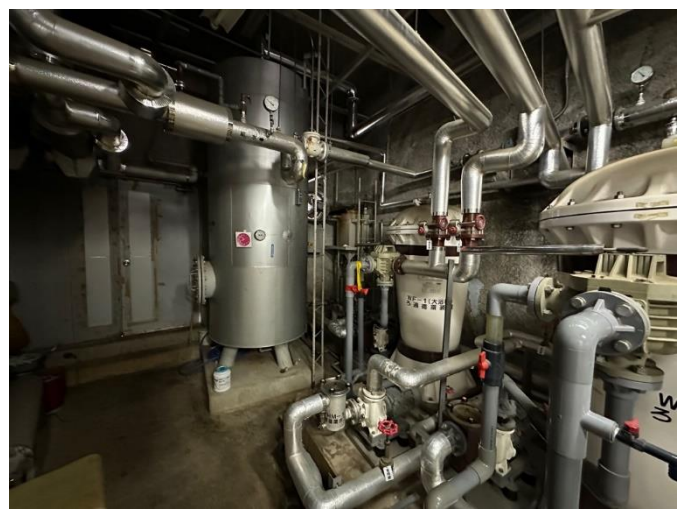
機械室（南側浴室用）②
