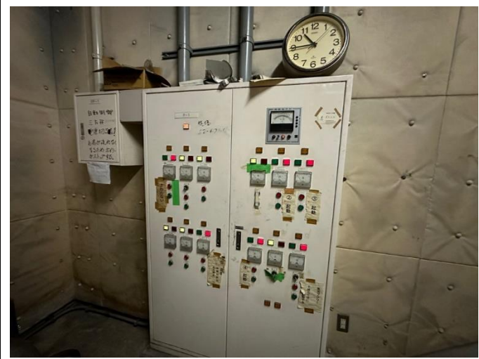
機械室（北側浴室用）①
