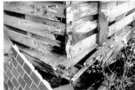
柱や土台の腐朽・蟻害
