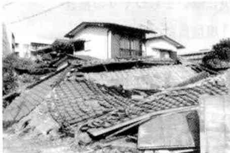
耐力壁の不足と老朽化による倒壊
