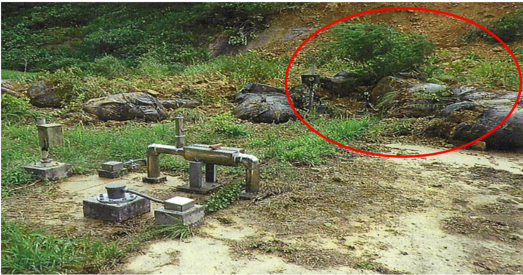
被災時の施設写真
