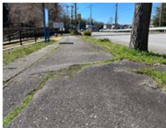
【街路樹により根上がりしている歩道】
