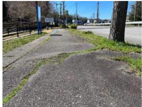
【街路樹により根上がりしている歩道】
