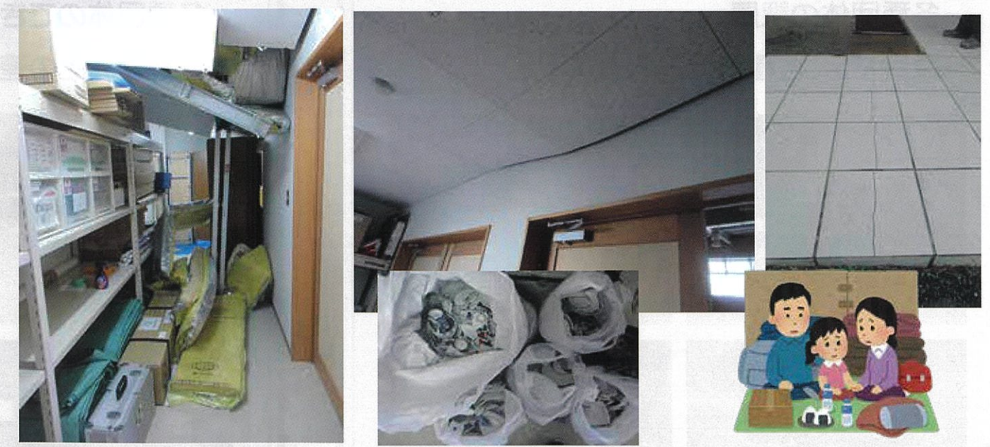
コミュニティセンターでも、多目的ホールの倉庫・器具庫の天井の落下、調理室の棚から崩れ落ちた食器が割れたりしました。
