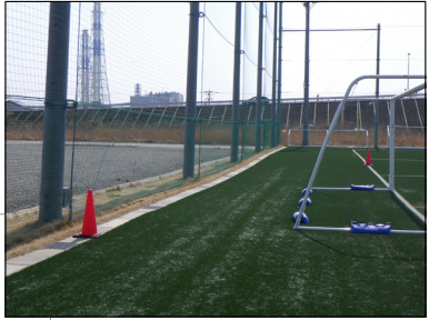
③人工芝・側溝の不陸(沈下)
