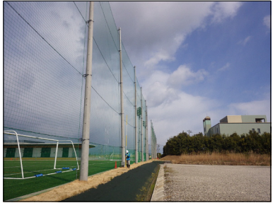
②防球ネットCo柱の傾き・沈下
