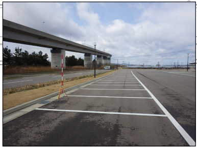
⑤As舗装・側溝・縁石の不陸(沈下)
