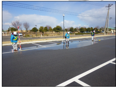
⑦As舗装の不陸(沈下)
