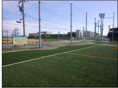
①液状化による土砂堆積、舗装・側溝の不陸
