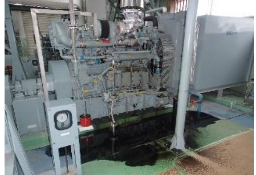
オイル漏れ状況(西部排水機場4号ポンプ)
