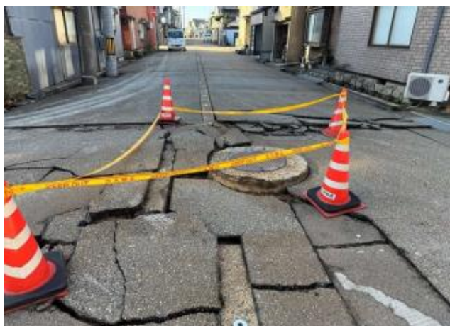
道路被害状況 (港町地内)
