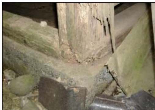
柱・土台の腐朽
