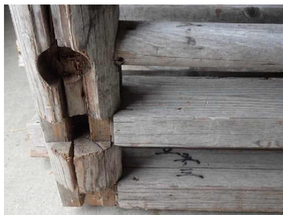
破損箇所の例（築山台擬宝珠高欄）
