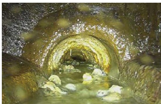
老朽化した汚水管渠内
