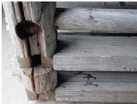
破損箇所の例（築山台擬宝珠高欄）
